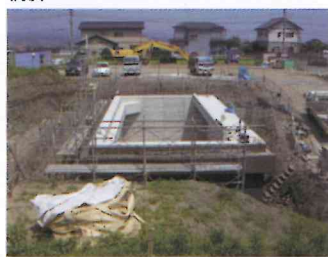
汚水処理施設
